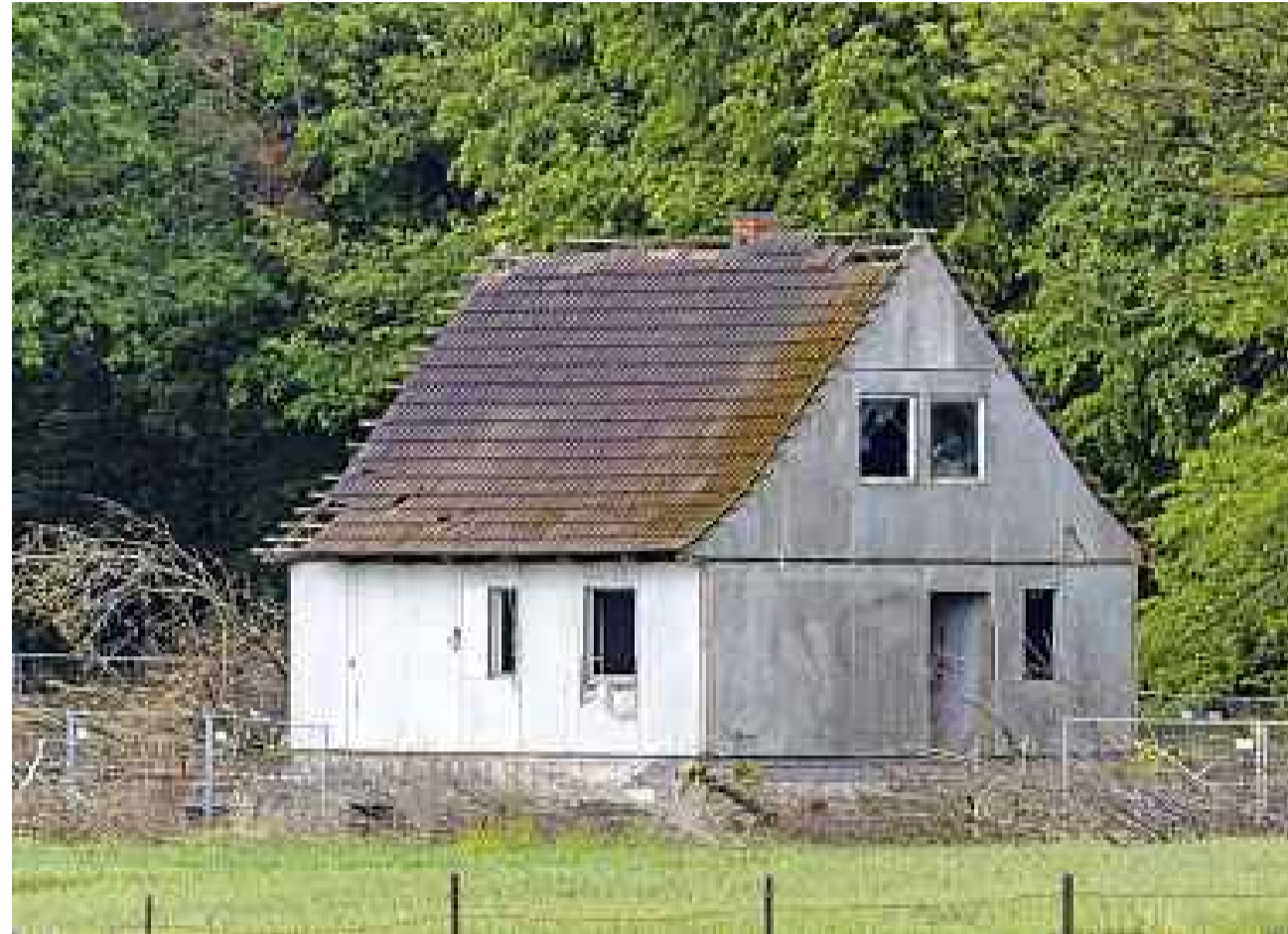
Gefährliche Ruine: Das Haus in Vorpommern wurde mit Asbestzementtafeln verkleidet.
